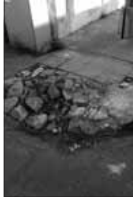
Il marciapiede distrutto in via Lido
